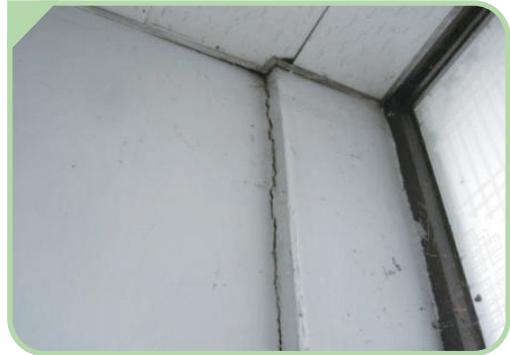
▲ 벽체 기둥 접합부 균열
