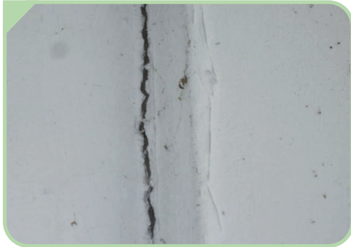
▲ 벽체 이질재 접합부 수직균열
