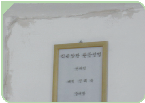
▲ 생활관 내부 벽체 보 기둥 부위 균열
