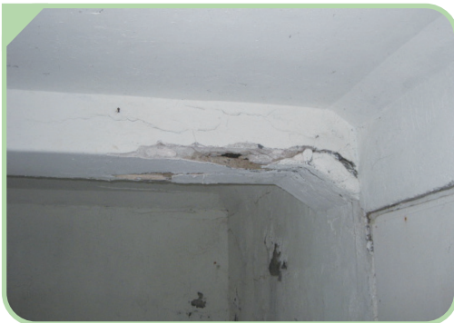
▲ 콘크리트 박락 및 전단균열
