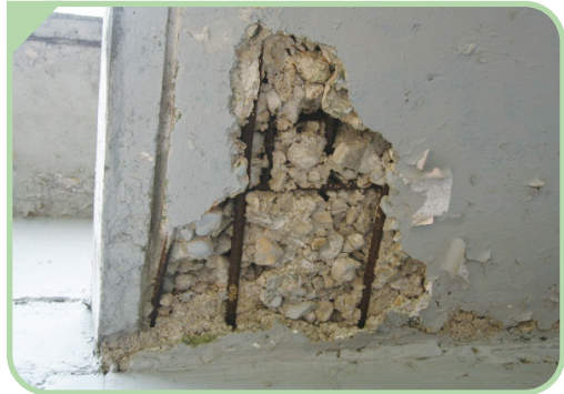
▲ 현관 케노피 하부 철근노출
