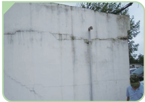
▲ 콘크리트 벽체 황균열
