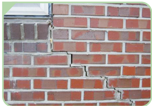
▲ 생활관 창틀하부 균열
