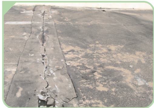
▲ 지붕 연결부 균열
