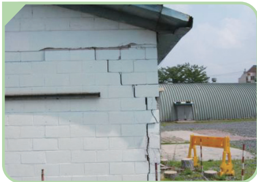
▲ 창고 벽체 균열
