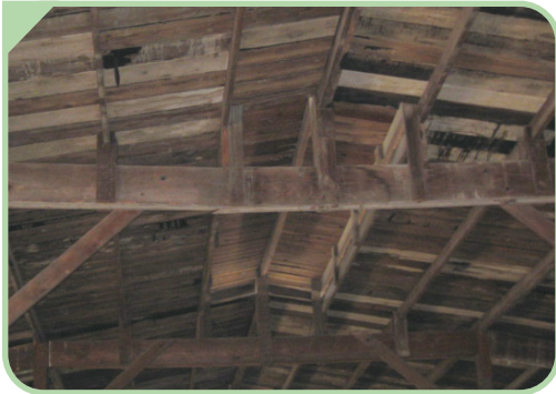
▲ 창고 목조 지붕틀 손상 및 평보 처짐
