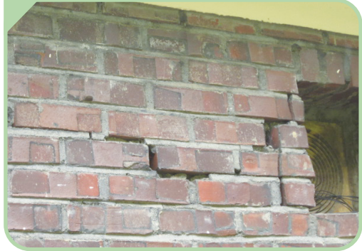
▲ 생활관 환기구 균열
