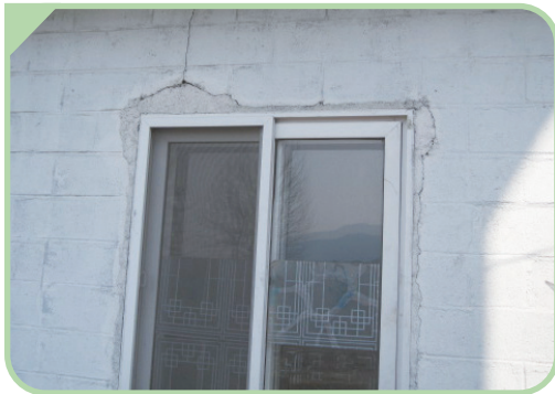
▲ 블록 벽체 균열
