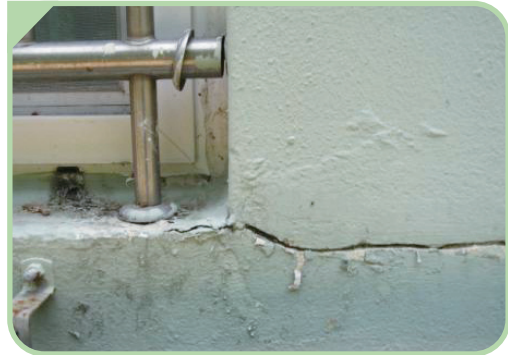
▲ 아파트 베란다 하부 균열
