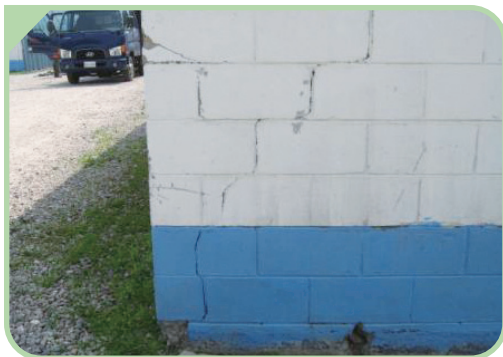
▲ 창고 블록벽체 균열
