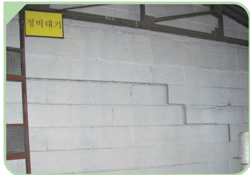
▲ 창고 벽체 균열
