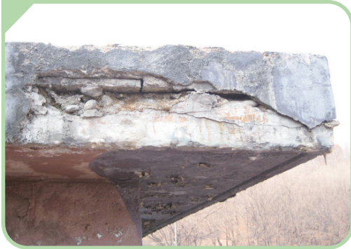
▲ 탄약고 지붕 콘크리트재료 분리
