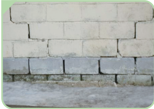
▲ 블록 벽체 균열
