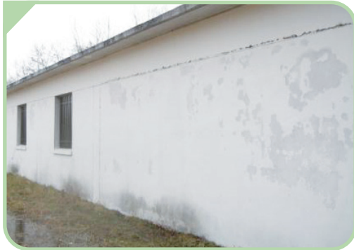
▲ 벽체 보 하부 균열
