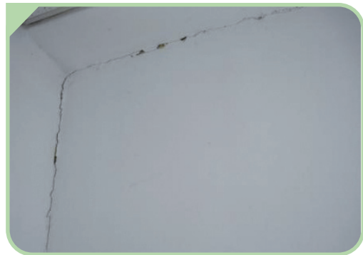
▲ 보 기둥 접합부 이질재 균열
