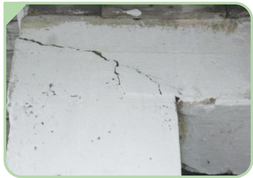
▲ 정비고 기둥 보 접합부위 균열
