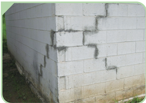
▲ 블록벽체 코너부위 균열
