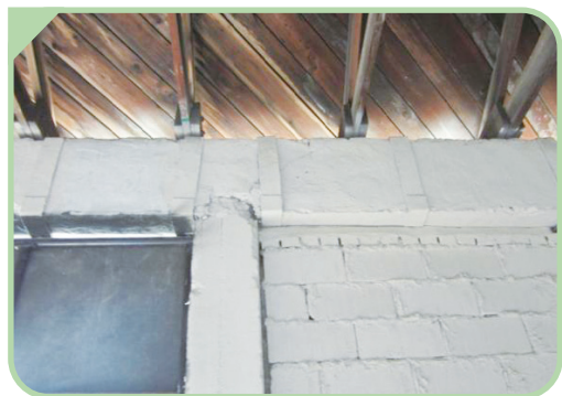
▲ 보 기둥부위 균열
