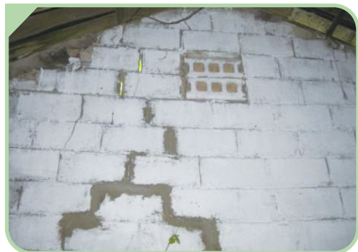
▲ 창고 벽체 균열
