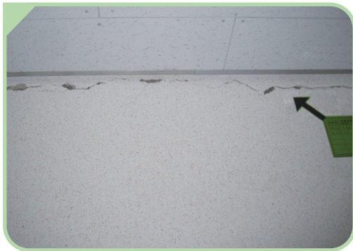
▲ 벽체 보 하부 횡균열
