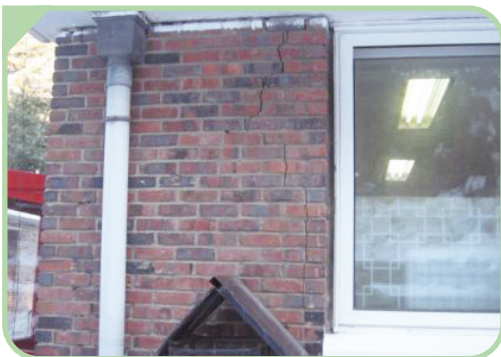
▲ 병영생활관 창틀주변 균열
