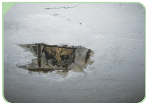
▲ 탄약고 천장 콘크리트 탈락
