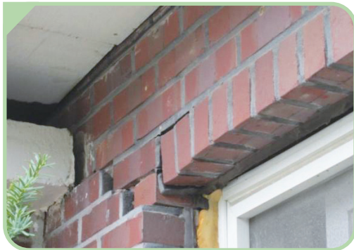
▲ 생활관 창틀상부 균열
