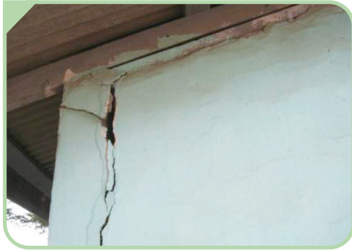
▲ 창고 벽체 코너부위 균열
