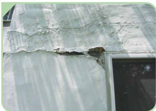
▲ 아파트 창틀부위 균열
