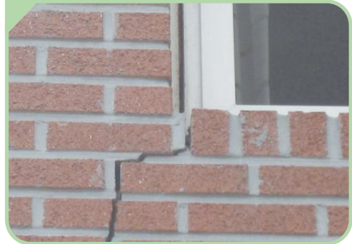
▲ 생활관 창틀하부 균열
