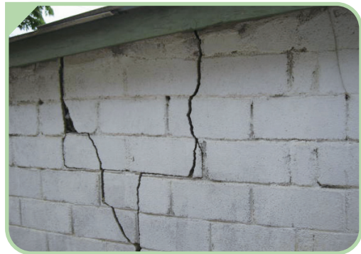
▲ 블록 벽체 균열
