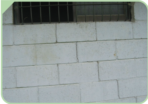
▲ 블록벽체 창틀하부 균열
