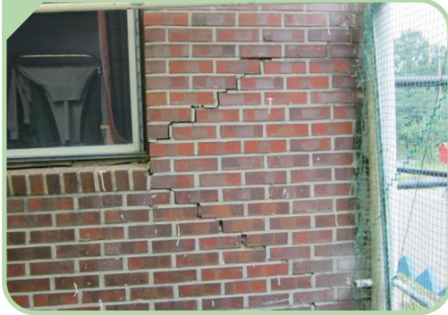
▲ 생활관 코너부분 균열
