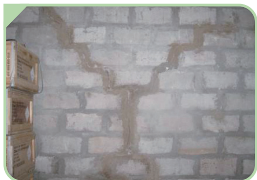
▲ 창고 내부 벽체 균열
