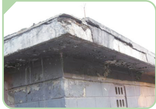
▲ 탄약고 지붕 슬래브 콘크리트 들뜸
