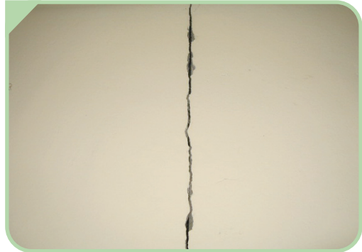
▲ 벽체 이음부분 균열
