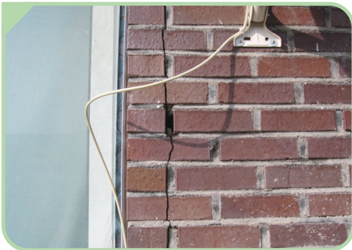
▲ 병영생활관 창틀 주변 수직균열
