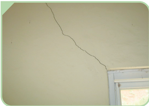
▲ 창틀 상부 사선균열
