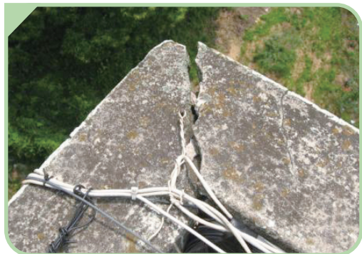
▲ 아파트 케노피 코너부위 균열
