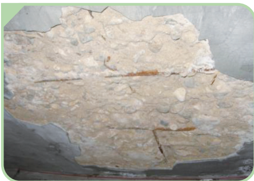
▲ 탄약고 천장 콘크리트 박락 및 철근노출
