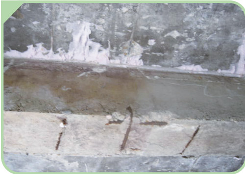
▲ 병영생활관 보 하부 균열 및 철근노출
