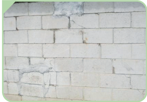
▲ 블록 벽체 균열
