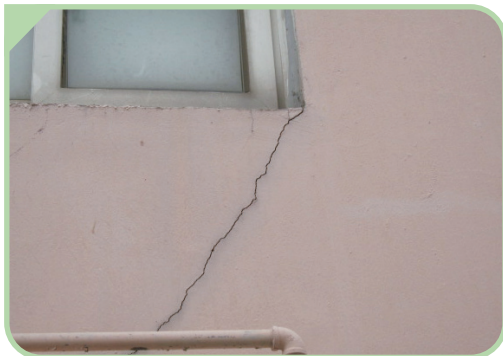
▲ 창틀 하부 벽체 균열
