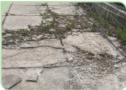
▲ 아파트 옥상 누름물탈 들뜸 및 파손
