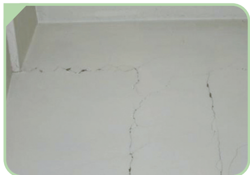
▲ 생활관 벽체 기둥 보 접합부 이질재 균열
