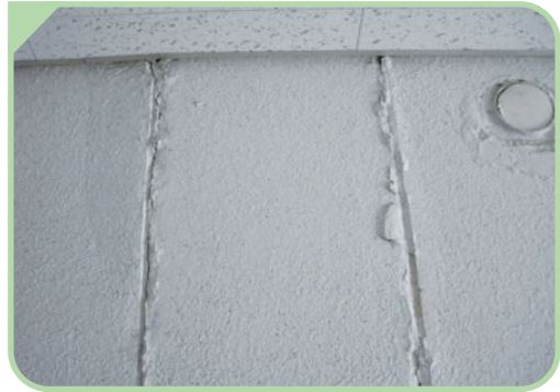
▲ 생활관 복도 기둥부위 이질재 접합부 균열
