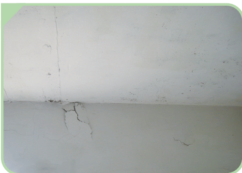
▲ 테두리보 콘크리트 박리
