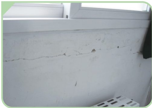
▲ 창틀 하부 인방주위 균열
