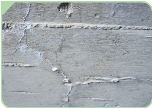
▲ 탄약고 천장 균열
