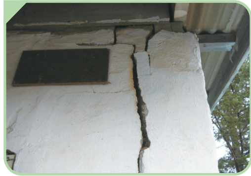
▲ 창고 벽체 코너부위 균열
