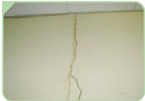
▲ 생활관 벽체 기둥 접합부 수직균열
