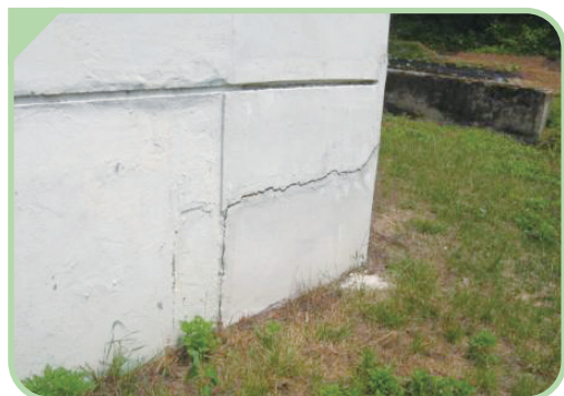
▲ 아파트 외벽 균열
