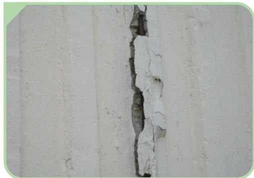
▲ 아파트 외벽 균열
