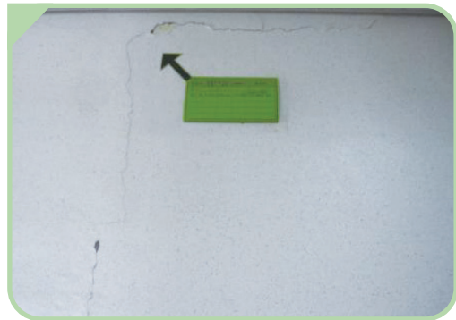
▲ 벽체 보 하부와 수직균열
