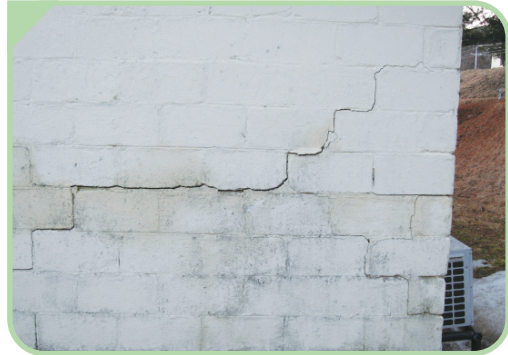
▲ 블록 벽체 균열
