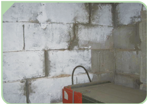
▲ 탄약고 내부 벽체 균열
