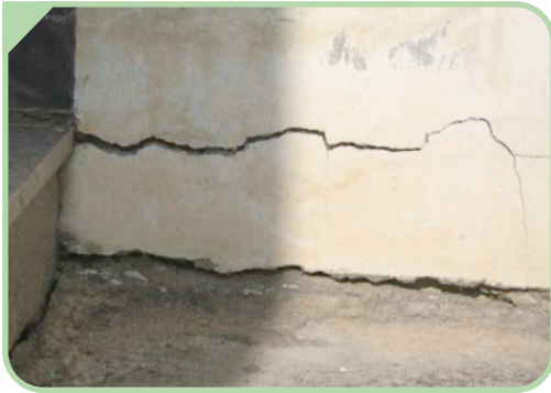
▲ 생활관 출입구 횡균열
