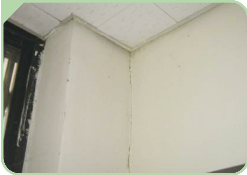
▲ 생활관 벽체 기둥부위 균열
