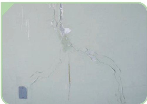
▲ 벽체 건조수축 균열
