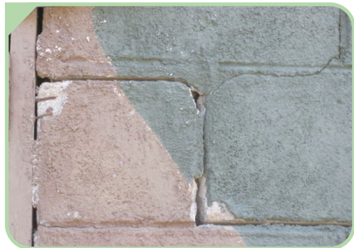
▲ 블록벽 줄눈부위 균열
