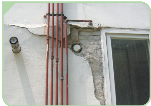
▲ 아파트 창틀부위 미장면 탈락
