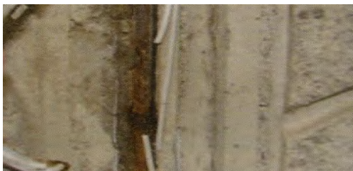
< 프라이머 도포 누락-실링제 탈락>
