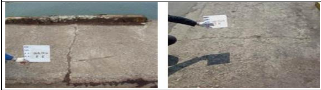
안벽 횡방향으로 과응력 균열 발생 사례
