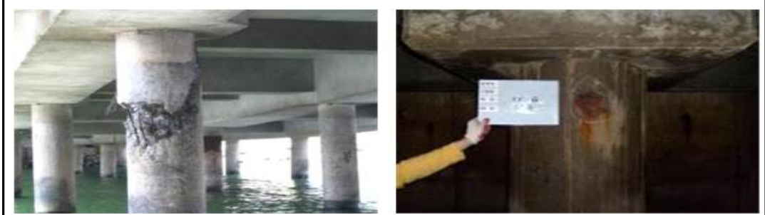
선박의 충돌로 인한 파손 사례
