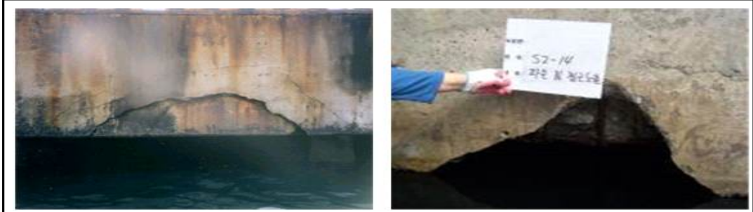
선박의 충돌로 인한 파손 사례
