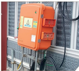
현장에 설치된 배전반
