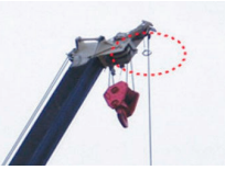
<권과방지장치 양호한 설치>
