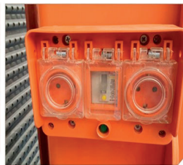
배전반 외부에 설치된 잠속기구
